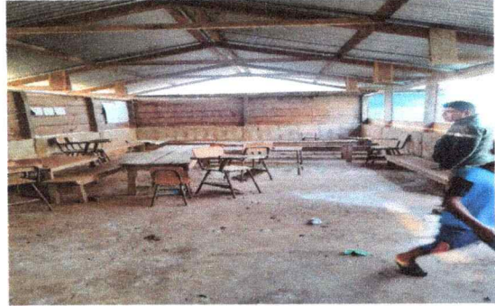
Foto 2: se observa en mal estado y en pasima condiciones del piso de las aulas
