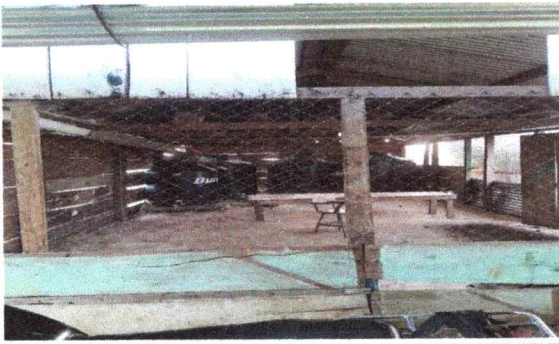
Foto1: se observa el mal estado de las paredes del aula y en pasima condicion
