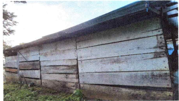
Foto 4: se observa la presencia de la humedad de las tablas y parales del edificio escolar, esta a punto de caer al suelo
