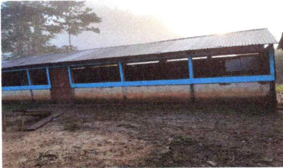
Foto 3: se observa que las estructura de lamina se encuentra en mal estado y se ha oxidado toda la estructura del modulo 1
